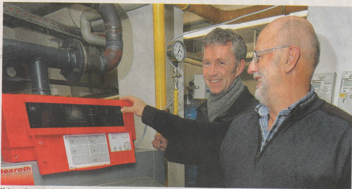
Heizungsbauer Andreas Hörmann und Josef Teufelhart (von links), Leiter der Betriebstechnik im Kurhaus, bei der Inbetriebnahme der neuen Heizungsanlage für das Kurhaus.
